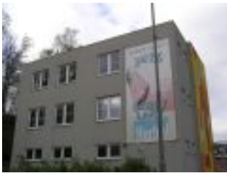
Stavební úpravy - dokončení kanceláří firmy v Liberci realizace 04 - 06/2014, kanceláře firmy v Liberci - stavební úpravy dokončení 1.p.
